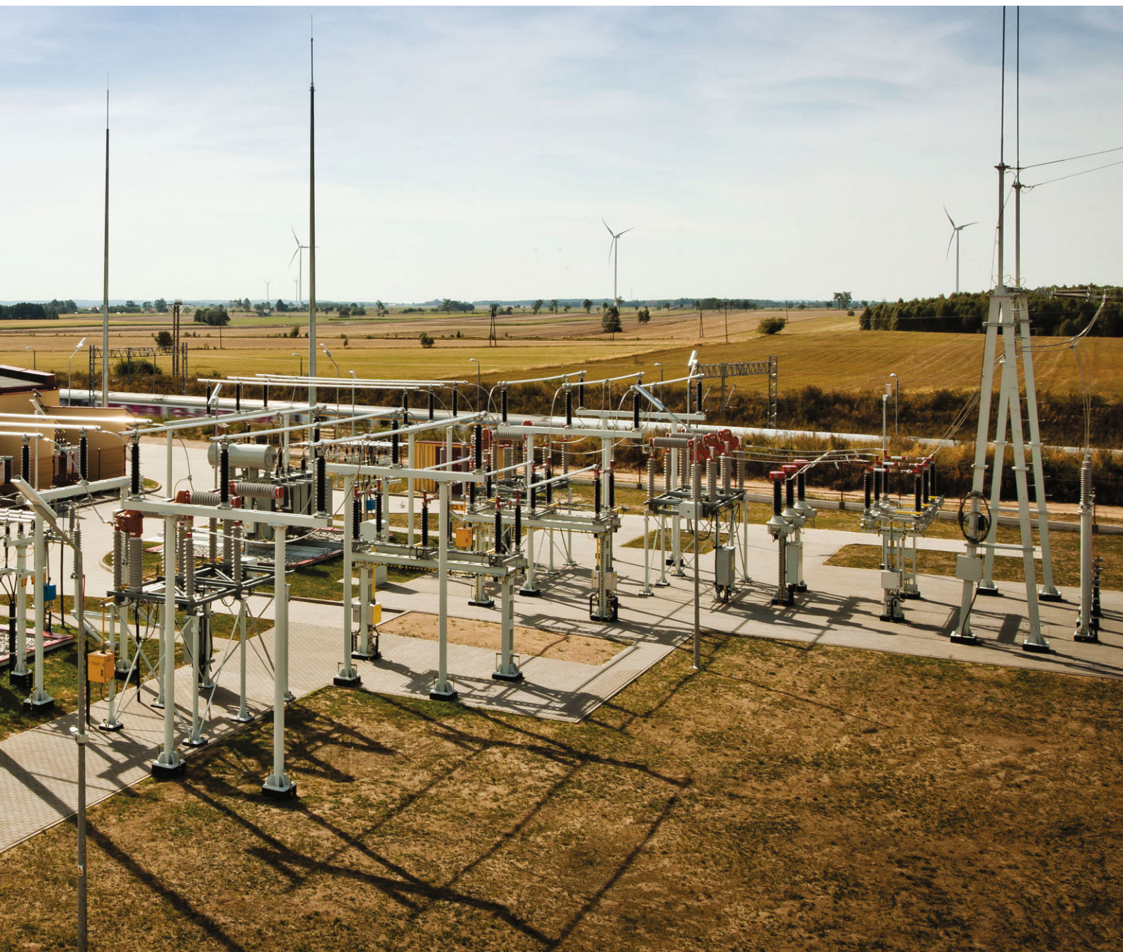
PGE Energetyka Kolejowa Operator, Rozdzielnia 110 kV w podstacji trakcyjnej systemu 3 kV prądu stałego
