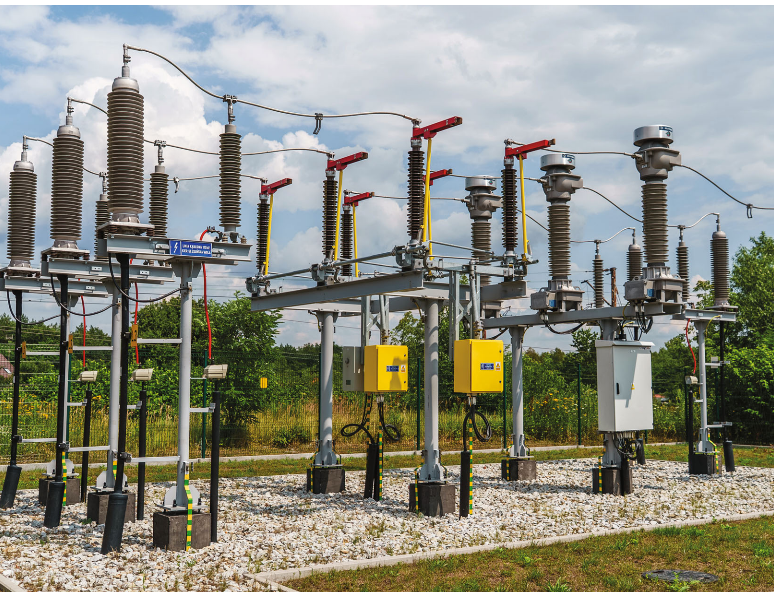
PGE Energetyka Kolejowa Operator, Pole liniowe w rozdzielni 110 kV w podstacji trakcyjnej systemu 3 kV prądu stałego
