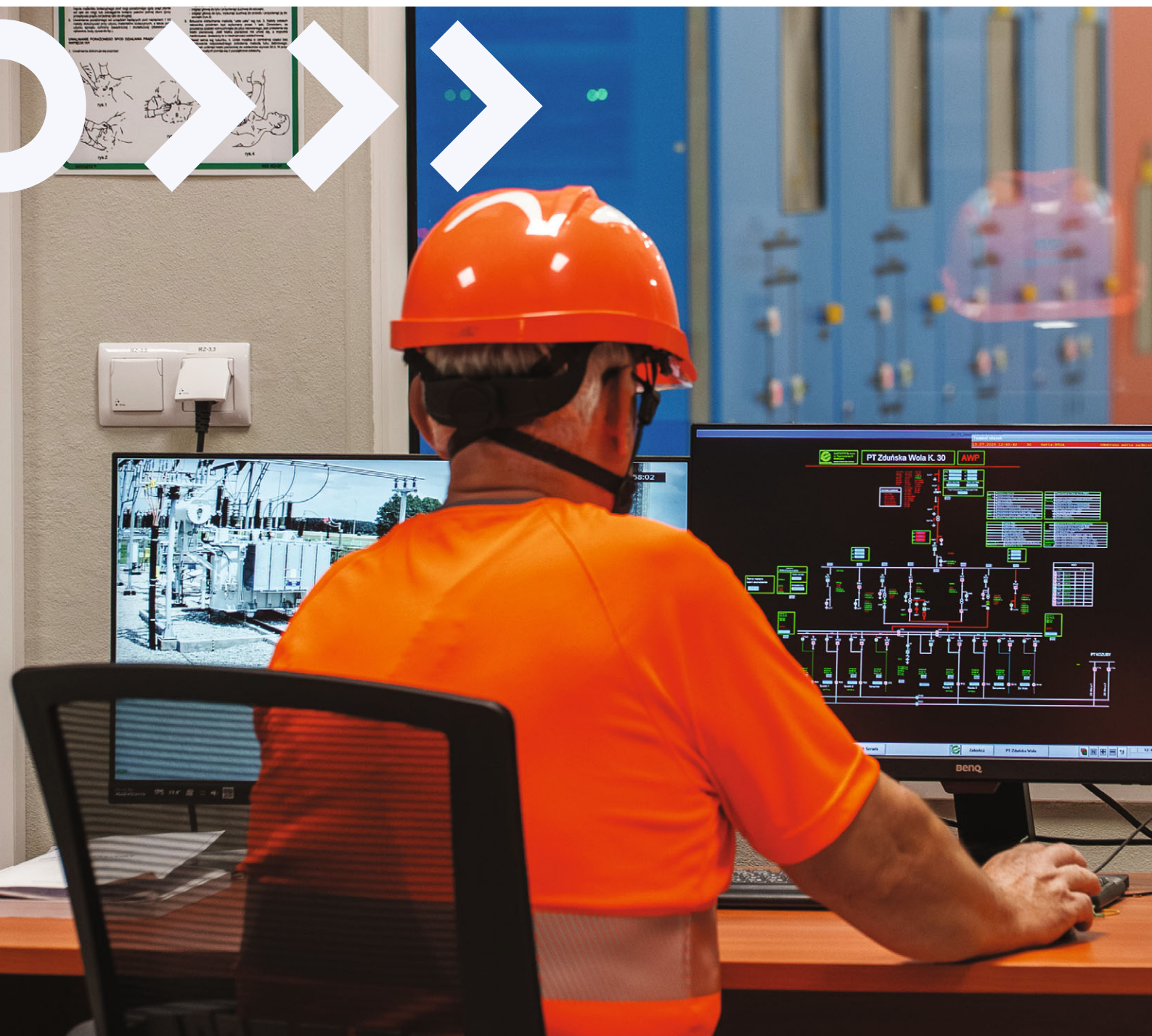
PGE Energetyka Kolejowa Operator, Lokalne stanowisko sterowania podstacją trakcyjną znajdujące się w jej wnętrzu
