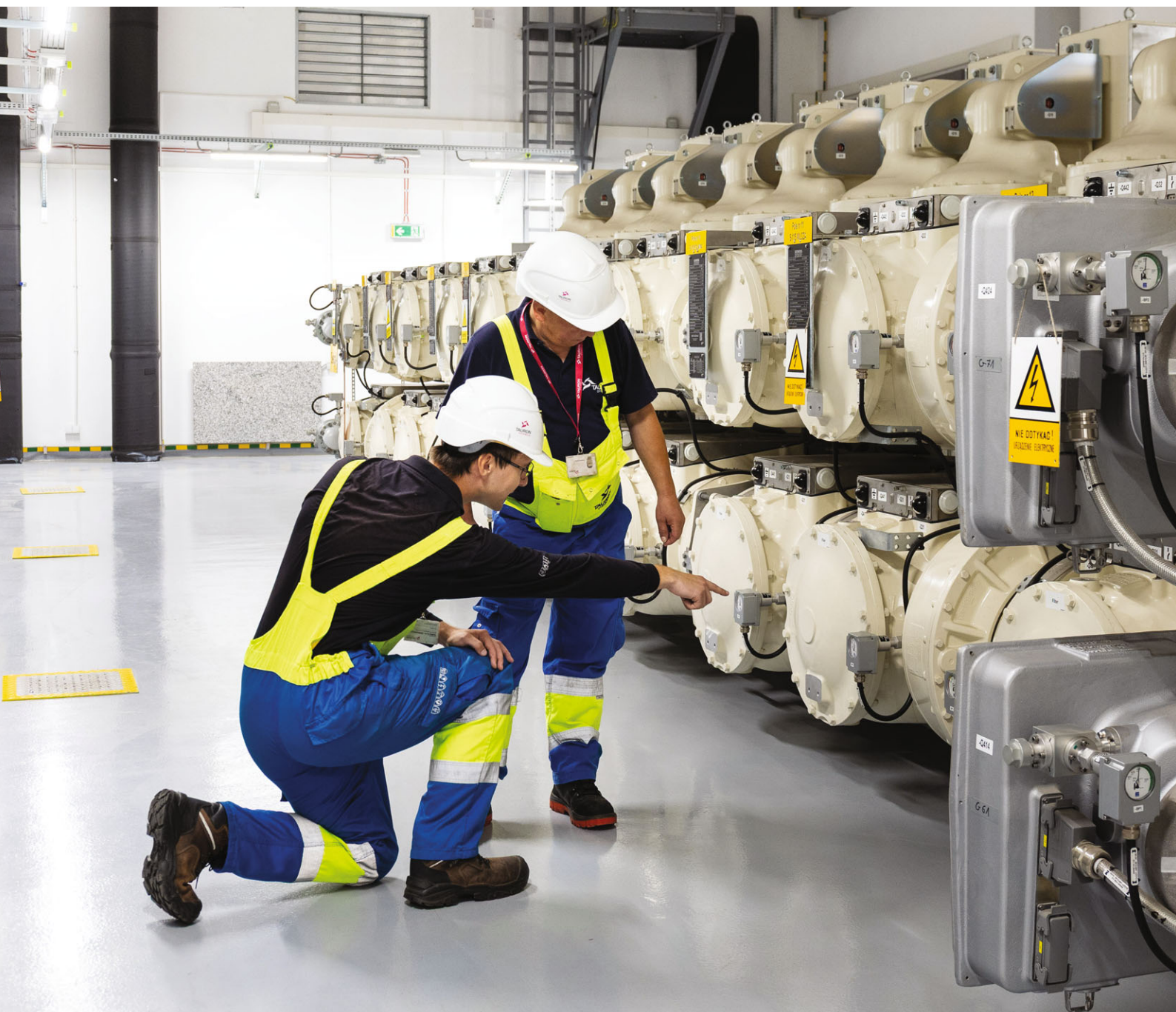
TAURON Dystrybucja, Stacja Czechnica zwiększy efektywność energetyczną i wesprze rozwój niskoemisyjnego ciepłownictwa oraz sieci dystrybucyjnej na Dolnym Śląsku
