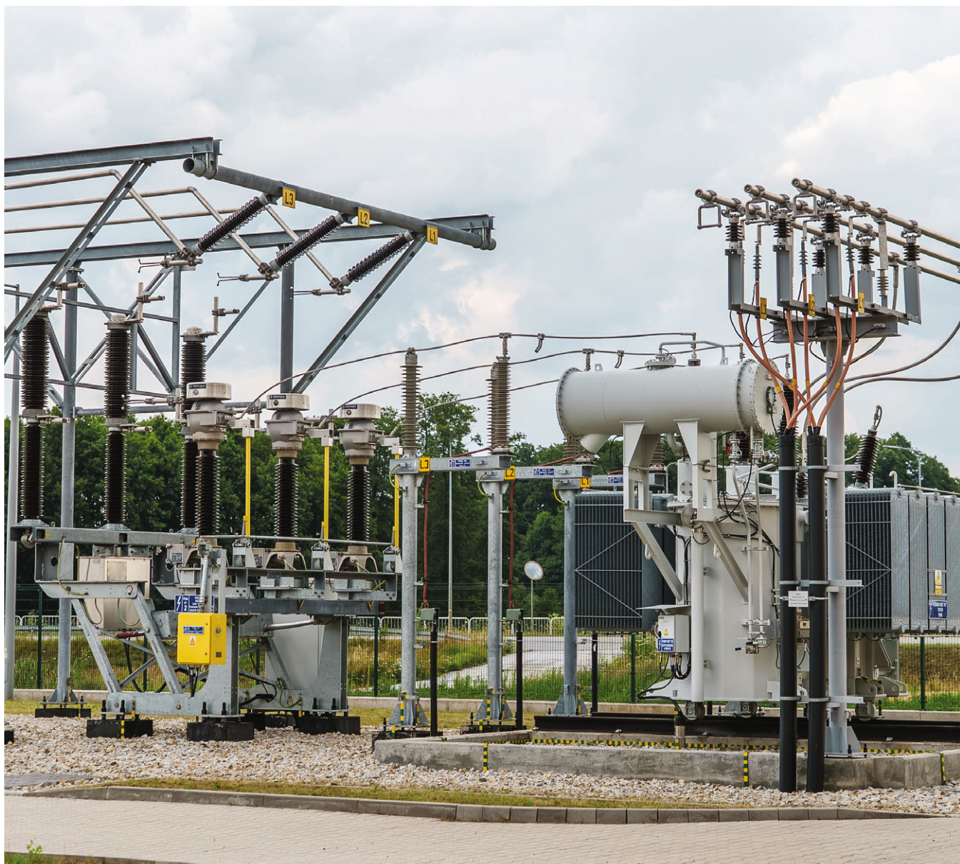
PGE Energetyka Kolejowa Operator, Rozdzielnia 110 kV i transformator mocy w podstacji trakcyjnej systemu 3 kV prądu stałego
