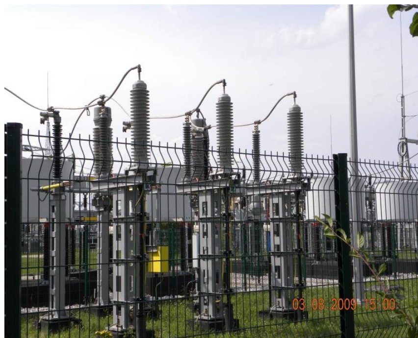
Ograniczniki przepięć na konstrukcjach wsporczych
