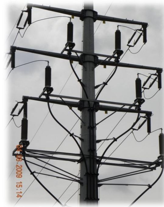
Ograniczniki przepięć na słupach kablowych
