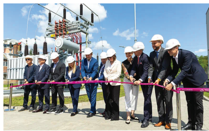
Nowoczesna stacja elektroenergetyczna Czechnica kosztowała 54,5 mln zł
