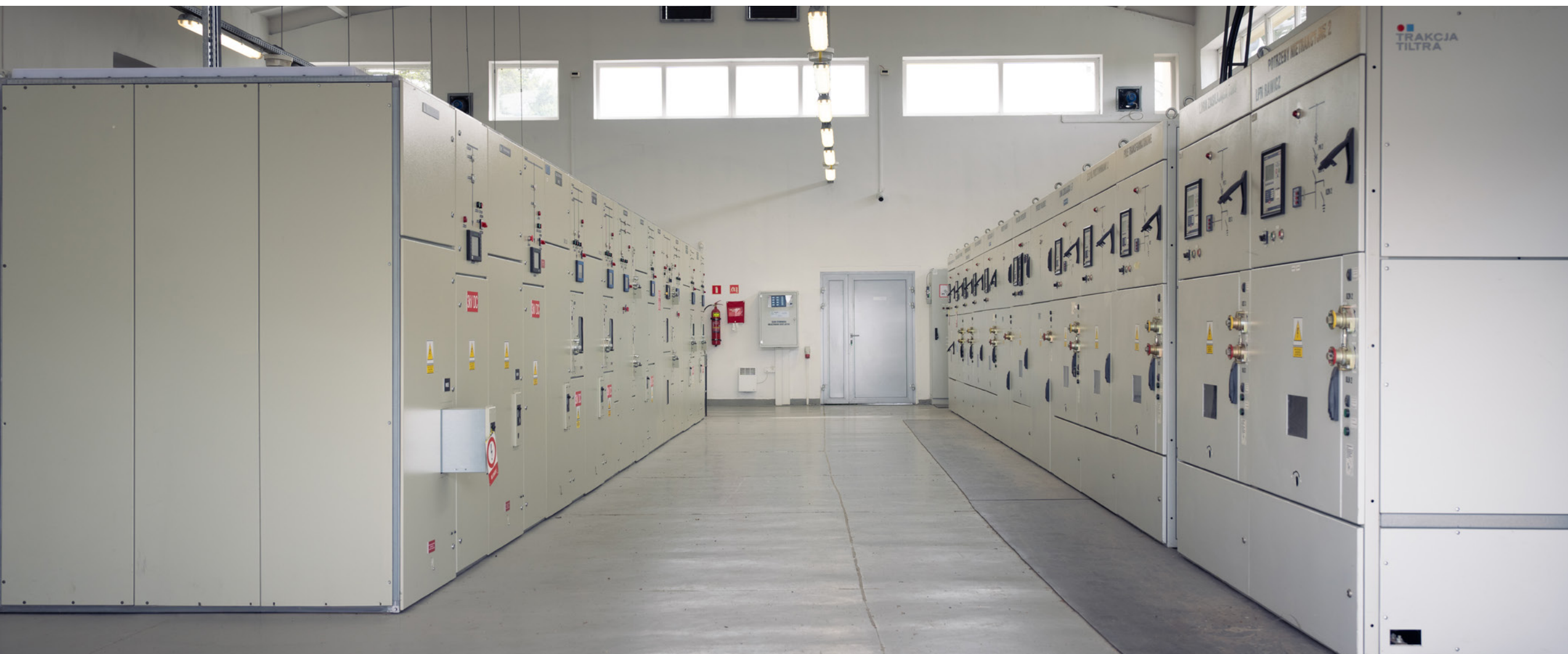
Podstacja trakcyjna, fot. PGE Energetyka Kolejowa
