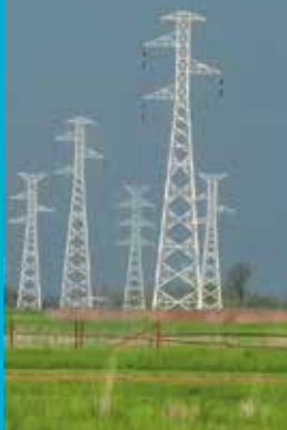
↑ POLSKIE SIECI ELEKTROENERGETYCZNE, LINIA STALOWA WOLA
